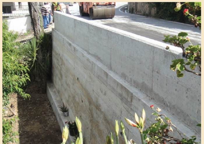
▶ Construção de muro de suporte à Estrada Municipal 554-1, no lugar de Vale da Anta, freguesia de Silva Escura
