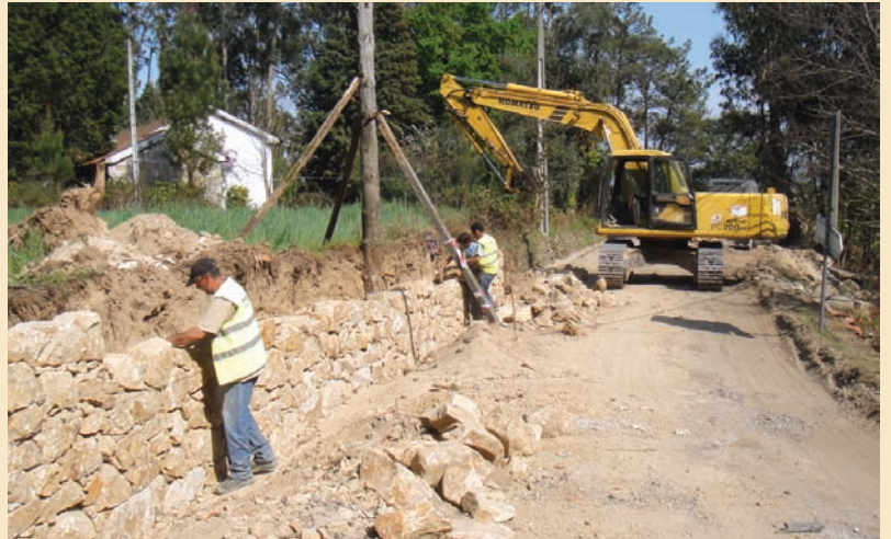
▶ Construção de muro no Caminho da Granja à Ribeirada (E.M. 569), após movimentos de terras para alargamento
