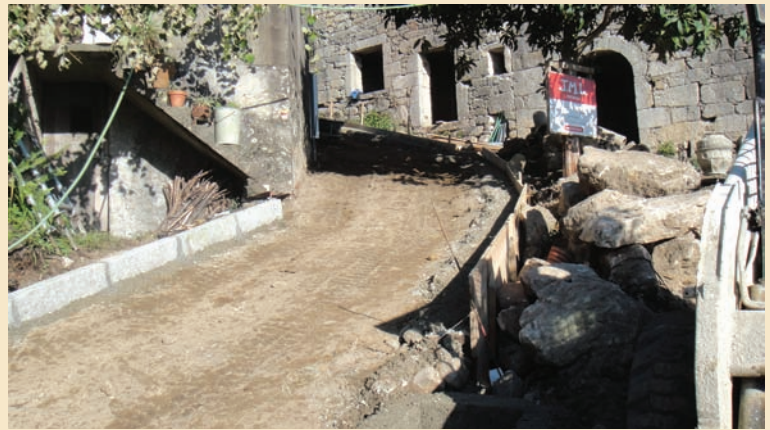
► Alargamento e pavimentação em calçada de cubos do Caminho Velho da fonte, na freguesia de Couto de Esteves
