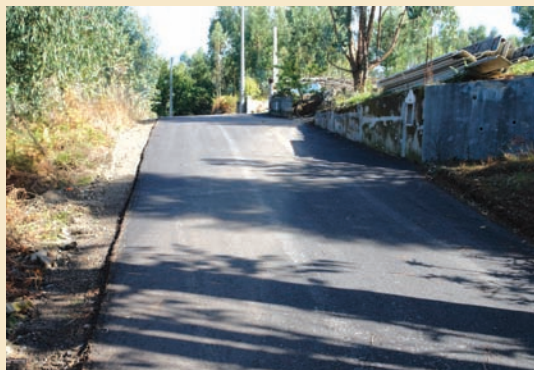
► Pavimentação em tapete beruminoso a quente, da Ruela da Lomba da Gândara, na freguesia de Pessegueiro do Vouga
