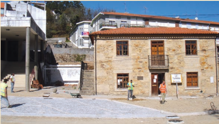
► EcoPolis: Regenerar Humanizar – Requalificação do Jardim do Lago – Pavimentação junto à Casa do Artesão e Posto de Turismo
