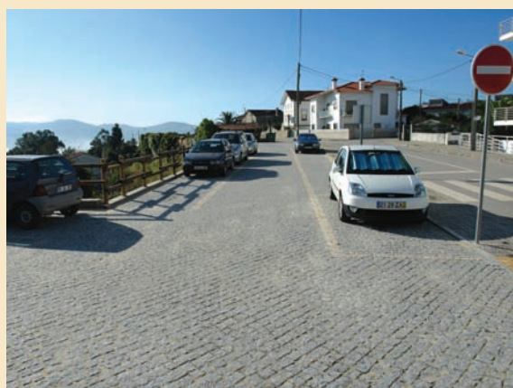
► EcoPolis: Regenerar Humanizar – Execução do estacionamento frente à pensão Bela Vista, junto à E. N. 328 (variante)
