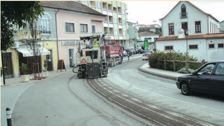
► EcoPolis: Regenerar Humanizar – Fresagem na avenida Comendador Augusto Martins Pereira, com vista à sua repavimentação em tapete betuminoso a quente
