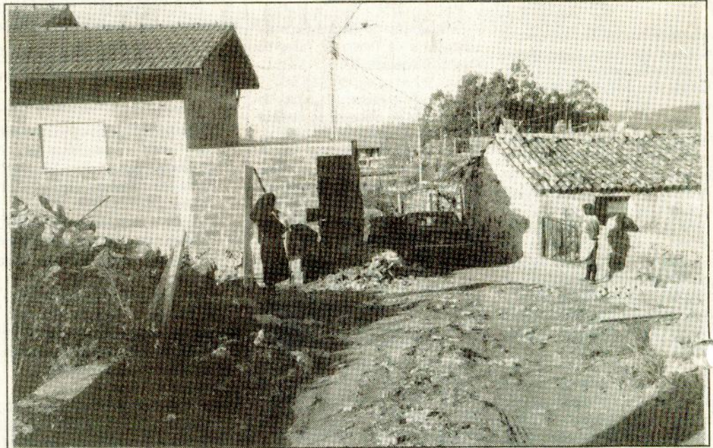
Carvalhal — Demolições para alargamento de estrada. Os proprietários cederam amigável e gratuitamente terrenos e construções para que a obra se tornasse realidade.
